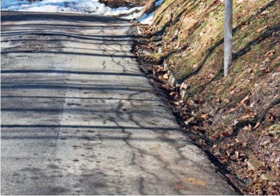
Stark deformierte bergseitige Fahrspur und deformierter Randstein unterhalb Rotmosgrabenbrücke
