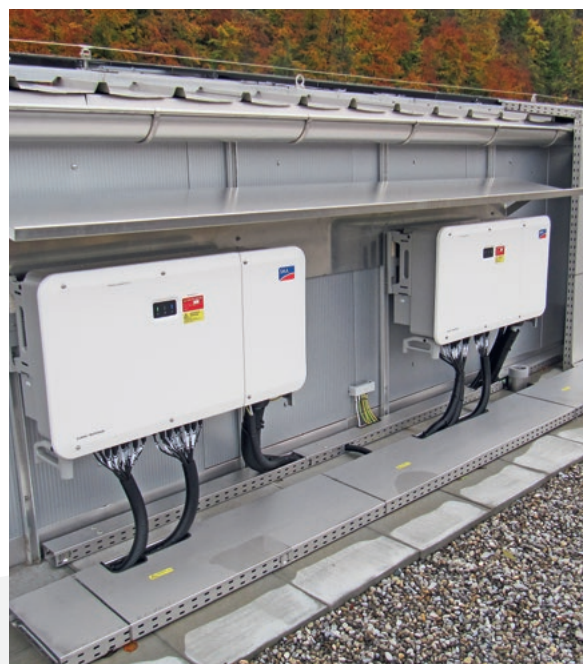
Wechselrichter auf Dach Bürotrakt Alligo AG
