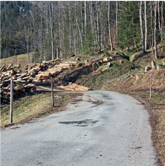
Stark abgesenkte Fahrbahn hinter Schwand
