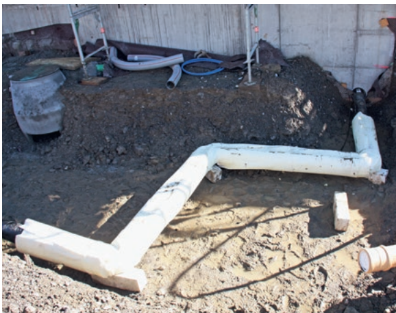
Hausanschluss Alligo AG, Gorgen 2: Stahl Doppelrohr DN 40 mit Dehnschenkel
