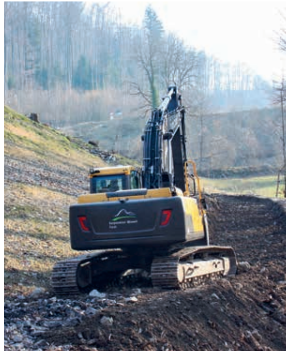
Erstellen des Planums für die neue Erschliessung «Stocki» unterhalb der Schüttung Buochholz
