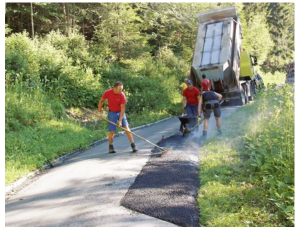
Einbau von HMT zum Aufschriften der talseitigen Fahrspur an der Zwirchistrasse vor Mettenlauibrücke durch Mitarbeiter des Forstbetriebs
