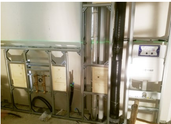
Sanitärinstallationen im Bad
