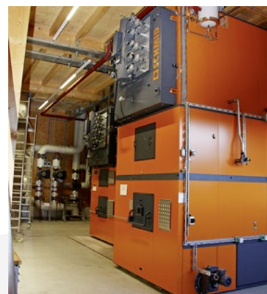
Der fertig installierte Heizkessel 3 mit einer Leistung von 2 MW
