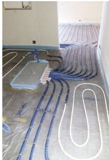
Bodenheizung mit Verteilkasten
