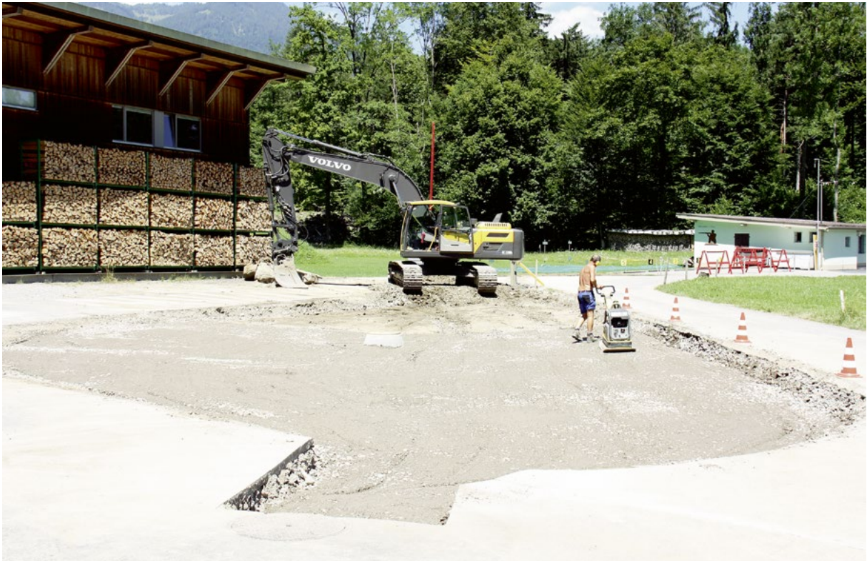
Peter Berchtold bei der Bauausführung. Mit der Vibroplatte wird die erste Schicht Kiesmaterial verdichtet
