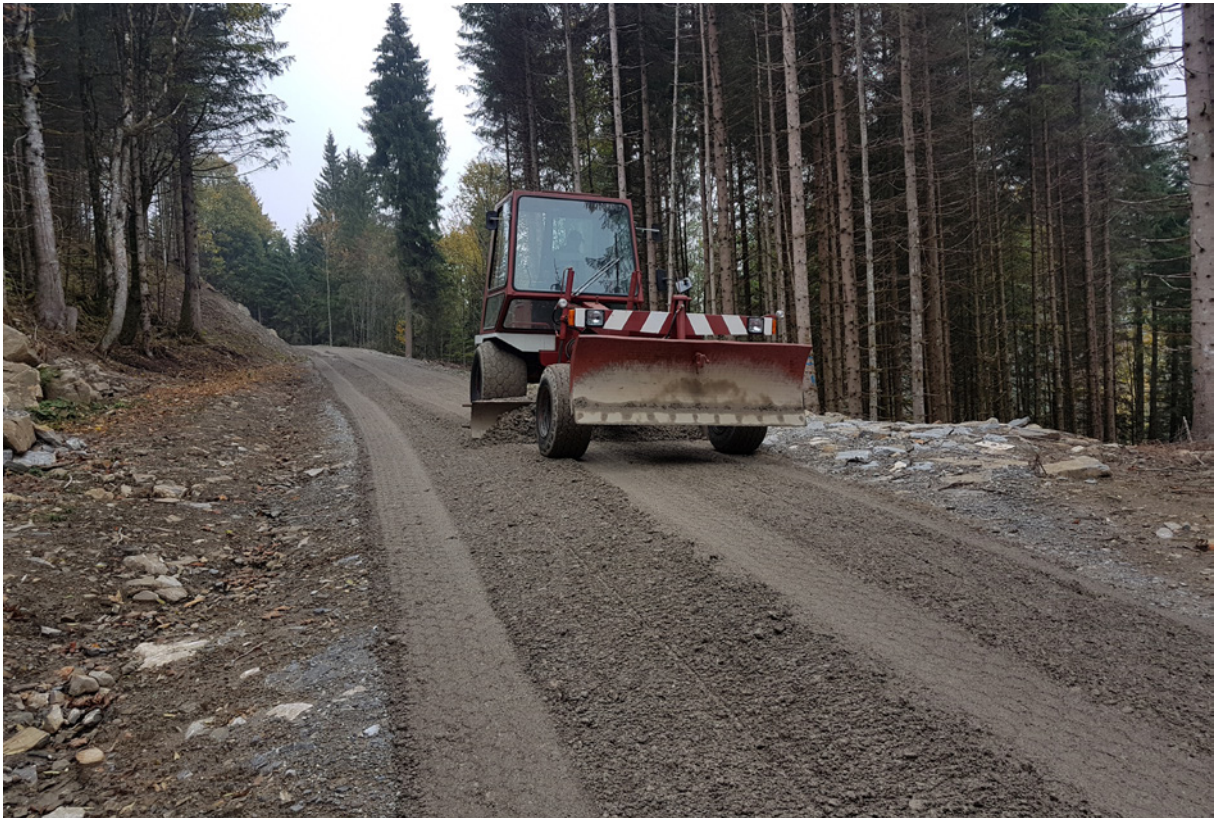
Einbau der Verschleisssschicht (Bergschotter 0–30 mm) mit Grader durch Walter Kiser, Land- und Forstwirtschaftstransporte, Giswil
